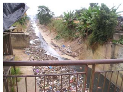
Eaux usées et déchets dans un caniveau –Abidjan
