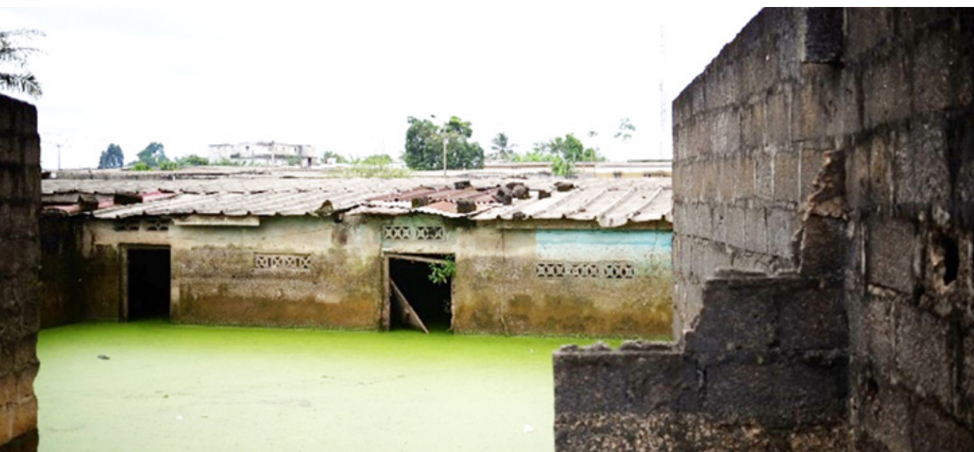
Exposition au risque d'inondation dans la commune d'Abobo, à Abidjan.
